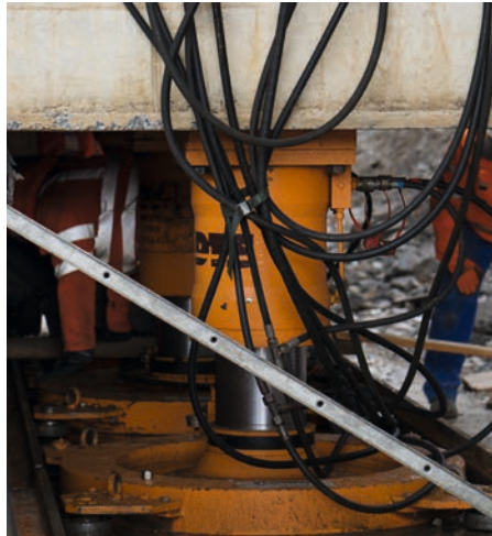
Nahaufnahme eines der Lastmodule mit hydraulischer Presse
