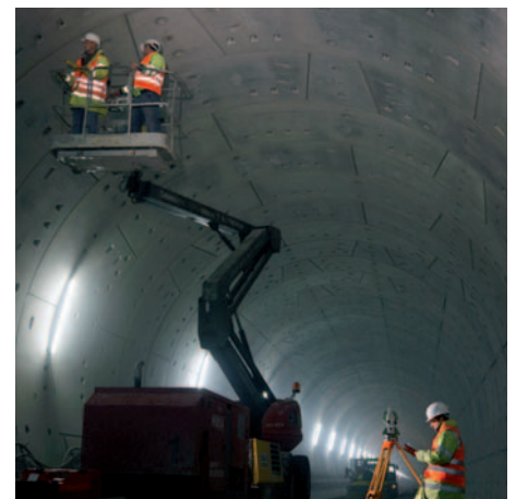
Um in acht Meter Höhe arbeiten zu können, werden neue Arbeitsbühnen eingesetzt
